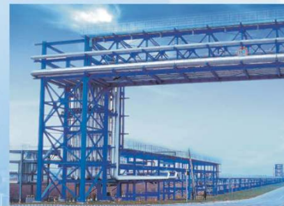
管廊 Pipe gallery 하수 처리장
