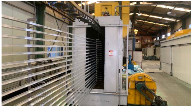
[ 랙(Rack) 이송방식의 도장시설 ]
