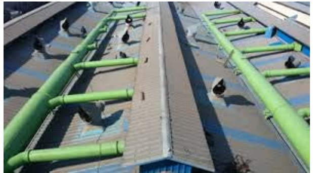
[ 고정식 벽체로 설치된 작업공간(건육집진시설) ]
