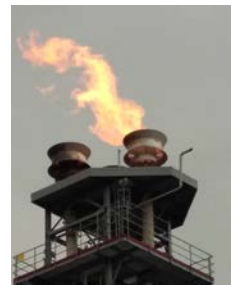
[ 배출가스 재이용시설 플레어스택 ]
