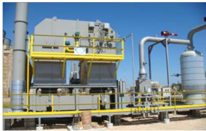
[ 축열식 연소산화시설 예시 ]
