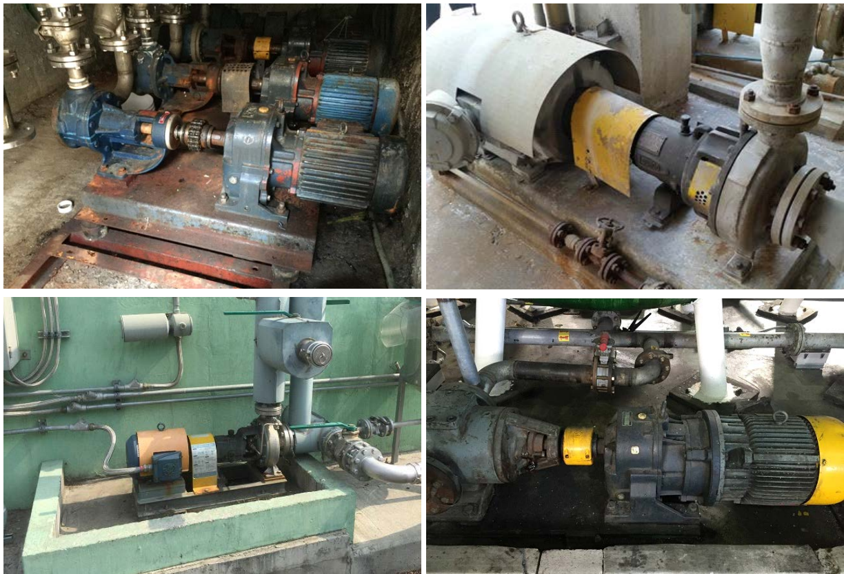
< 그림 4-89 > 단일기계봉인시설 설치 펌프 예시
