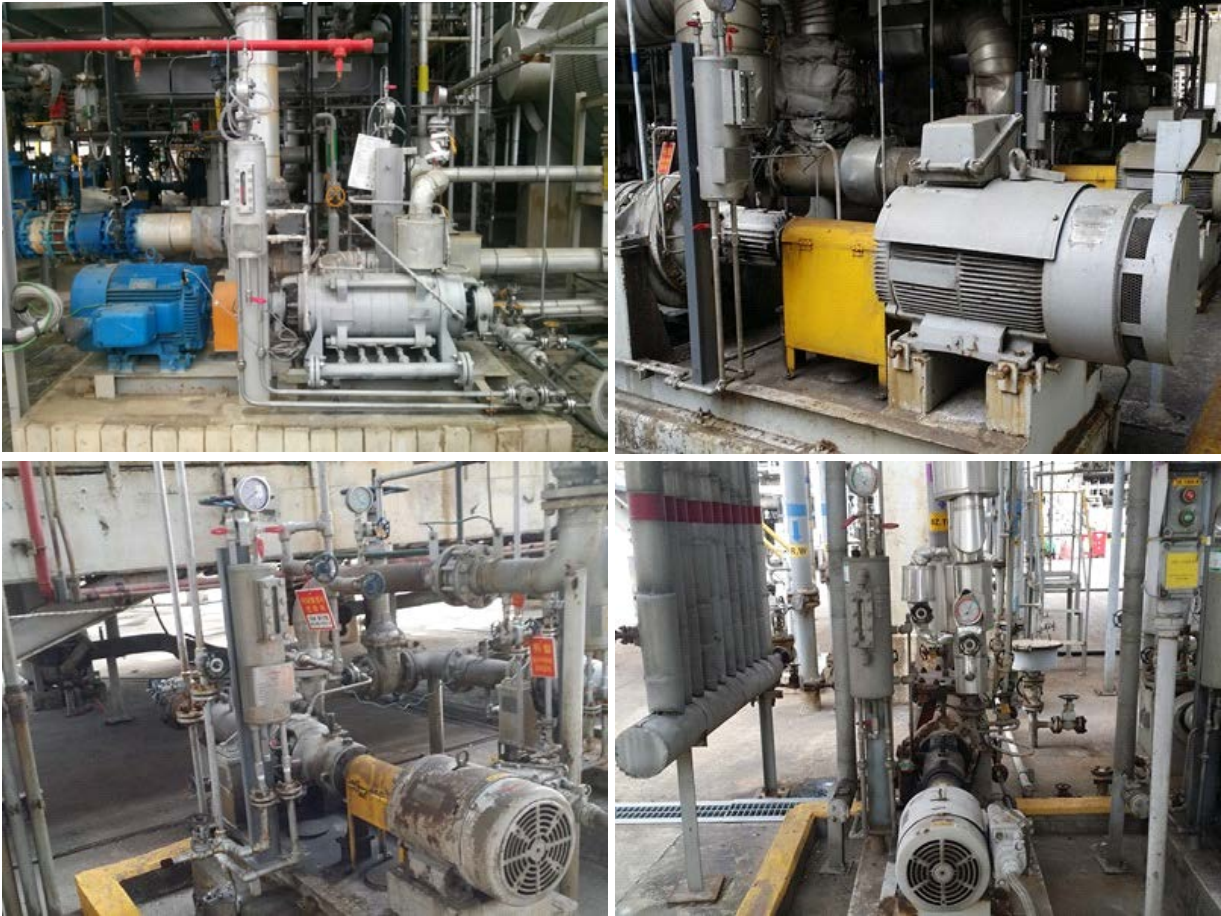
< 그림 4-234 > 이중기계봉인시설 설치 펌프 예시
