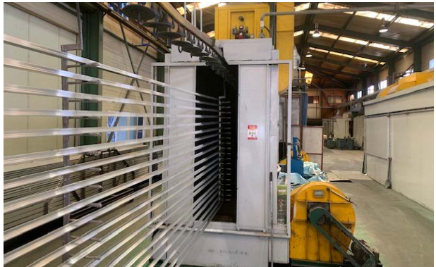
[ 랙(Rack) 이송방식의 도장시설 ]
