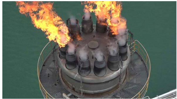
[ 스팀 과량투입에 따른 배출가스 불완전연소 사례 ]
