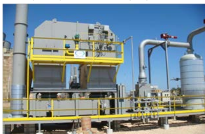
[ 축열식 연소산화시설 예시 ]
