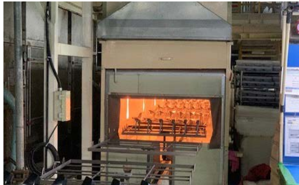
[ 컨베이어 이송방식의 건조시설 ]
