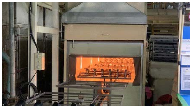
[ 컨베이어 이송방식의 건조시설 ]
