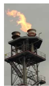
[ 배출가스 재이용시설 플레어스택 ]
